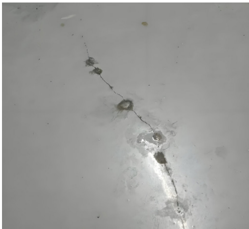
图2 劣质防水涂料涂膜开裂渗水示例图
