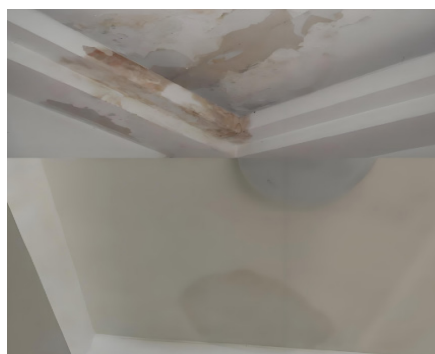
图1 墙体和屋面渗漏示例图
