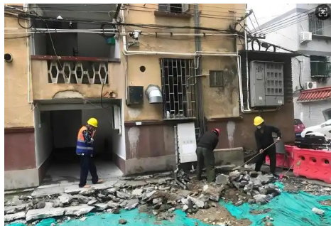
图1 老旧小区外部状态图
