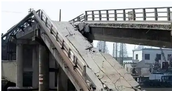
图2 桥梁基础坍塌事故
