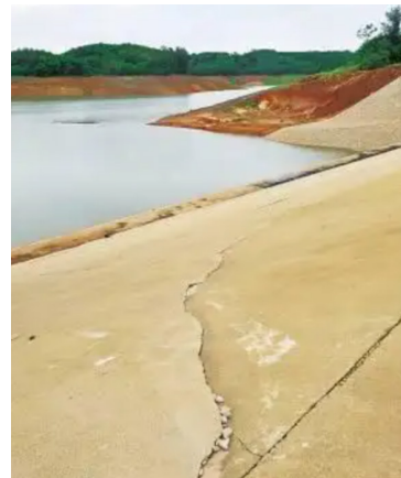
图1 某小型水库大坝裂缝示意图
