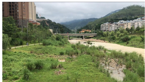
图2 桩号W1+563治理前
