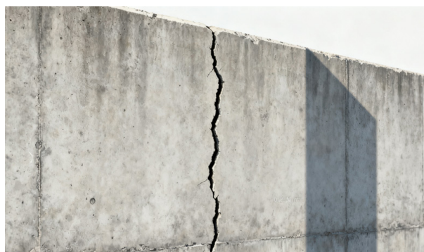
图1 项目墙体裂缝
