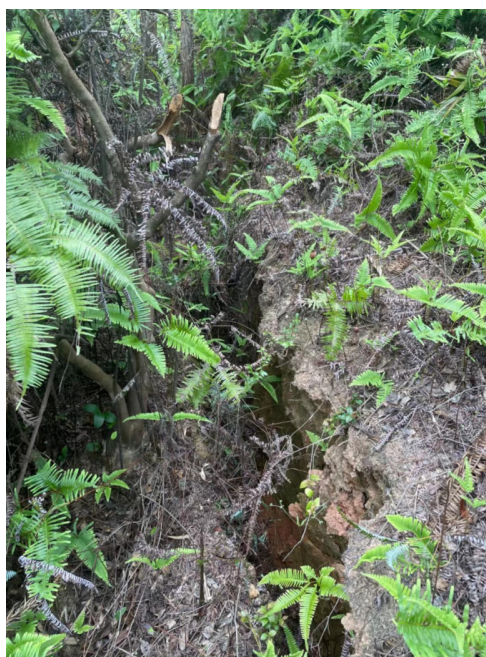
图2 现场裂缝情况
