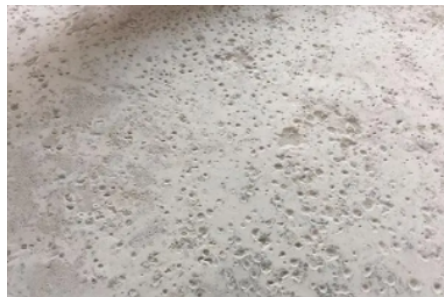
图二 混凝土麻面问题
