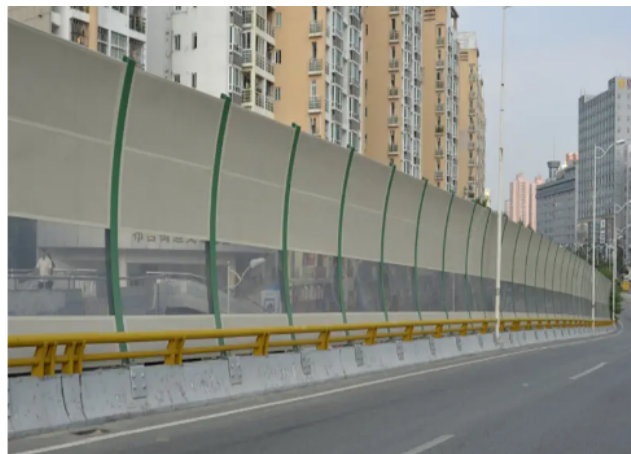
图2 公路交通运输工程噪声屏障设施
