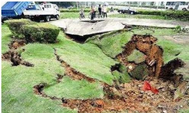
图1 地下水位下降形成的地面塌陷
