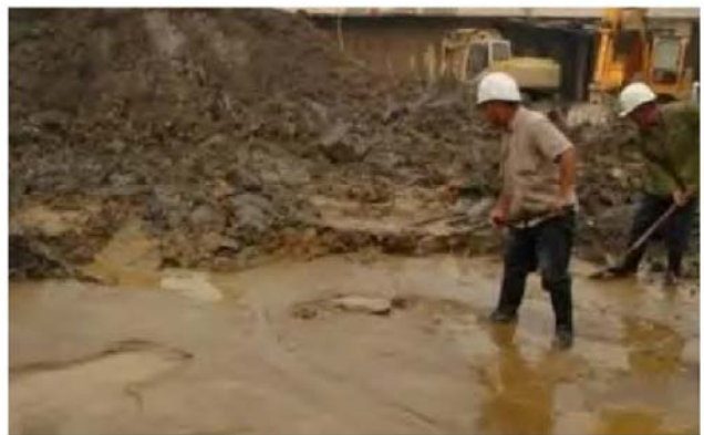
图2 基坑突涌对工程的危害
