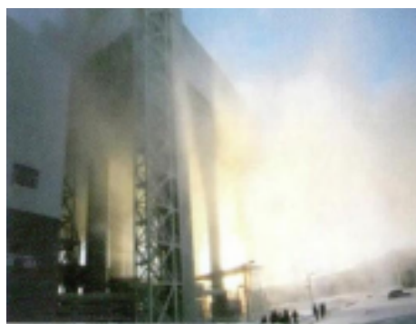
图1 冬季辅机冷却塔散发水蒸气
