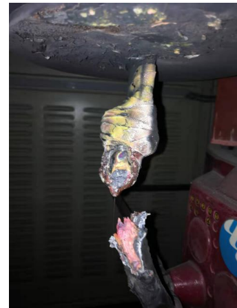
图 6 4号机励磁变A相高压侧引线烧损
