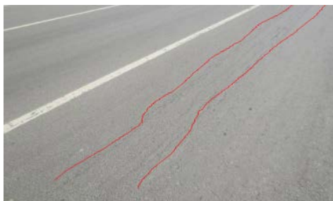
图3桥面铺装纵向裂缝
