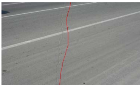
图2桥面铺装横向裂缝
