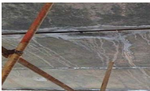
图4铰缝处渗水析白
