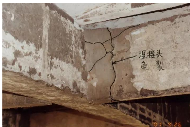
图1 钢架拱桥横隔板湿接头收缩裂缝
