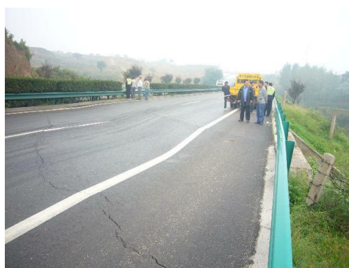
图1 农村公路水泥面板裂缝
