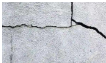
图一 结构裂缝
