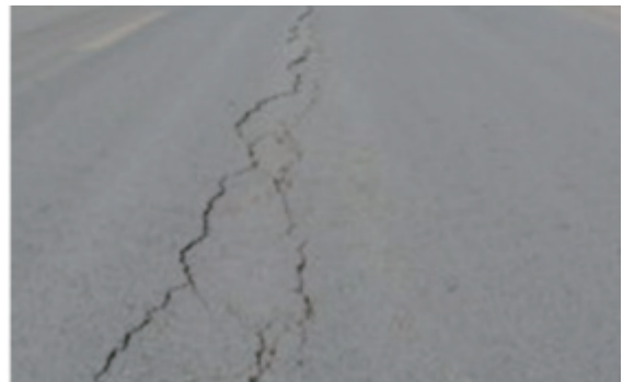
图1. 道路桥梁裂缝
