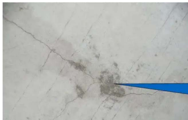
图2混凝土温度收缩裂缝
