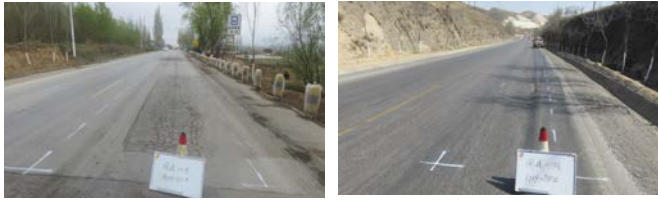
图1 G211线k289+200、k209+750处路面结构层损坏
