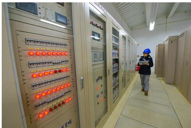
智能变电站投入运行
