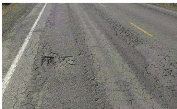
图一公路裂缝
