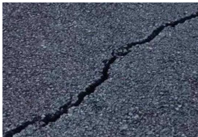
图1 沥青路面裂缝
