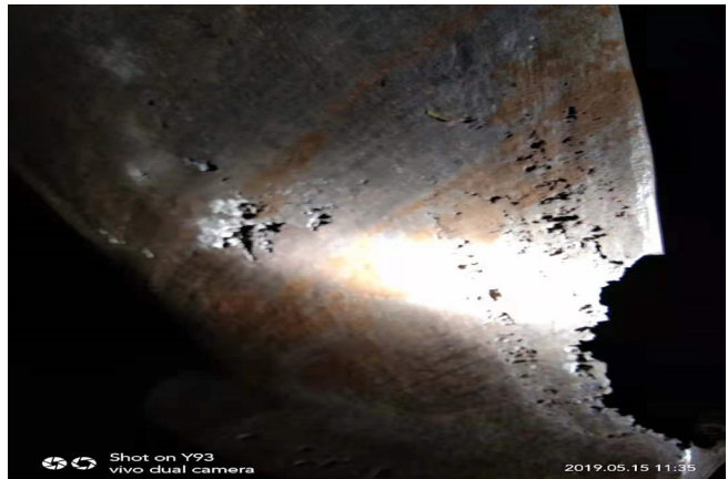
图2 脱硫塔搅拌器叶片腐蚀
