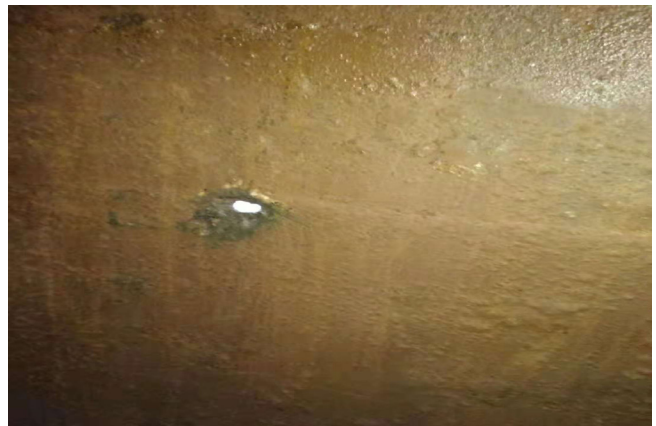
图1 脱硫塔壁点蚀
