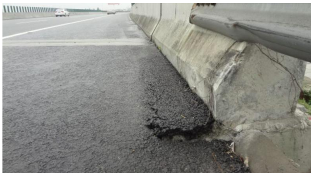
图3 不均匀下沉出现伸缩缝
