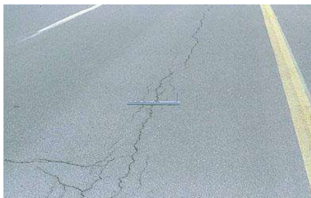
图1 公路混凝土裂缝
