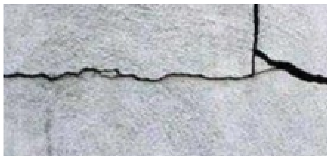
图一 混凝土裂缝
